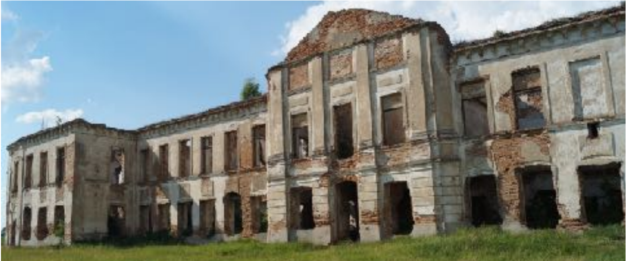
Mocno zrujnowany pałac księcia Dominika Zasławskiego.
